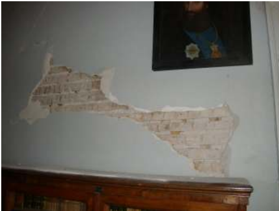
Φωτογραφία 11: Ρωγμές σε εσωτερικό ξυλόπηκτο τοίχο.
