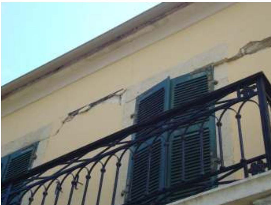
Φωτογραφία 10: Οριζόντιες ρωγμές στο σύνολο των πεσσών του ορόφου κάτω από τα ενισχυμένα υπέρθυρα.
