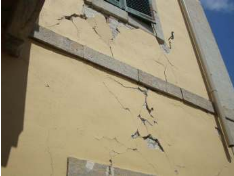
Φωτογραφία 7: Διαγώνιες ρωγμές σε υπέρθυρο και ποδιά.
