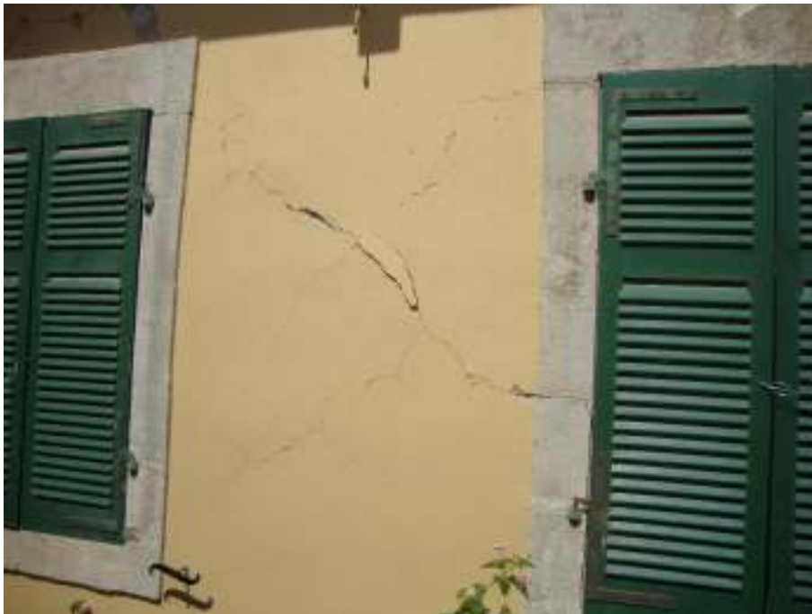
Φωτογραφία 5: Διαγώνιες χιαστί ρωγμές σε πεσσό.
