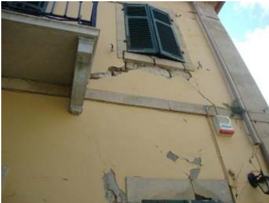
Φωτογραφία 8: Διαγώνιες ρωγμές σε υπέρθυρο και ποδιά.
