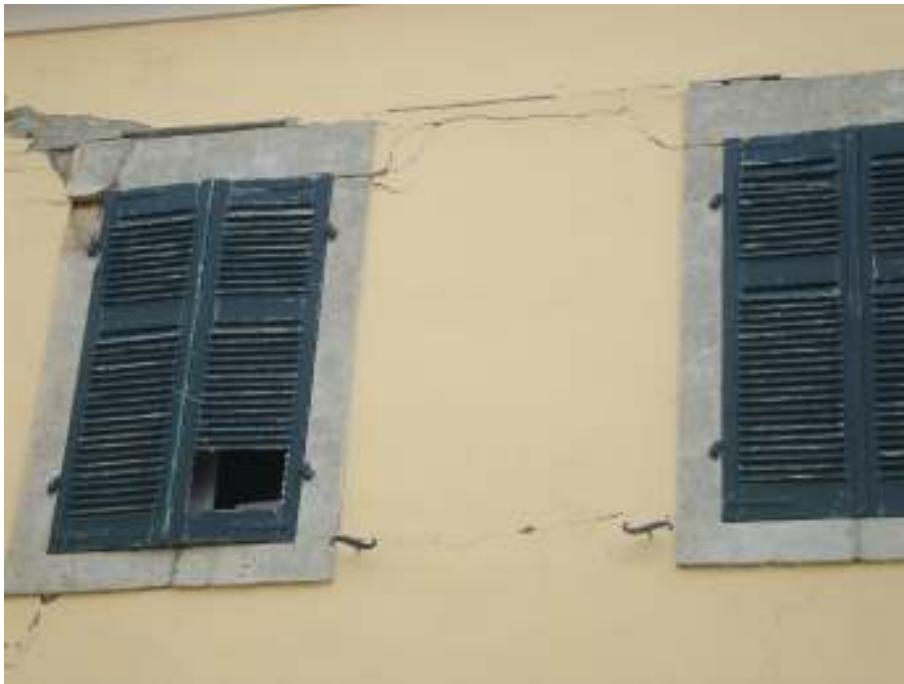
Φωτογραφία 9: Οριζόντιες ρωγμές σε πεσσό.
